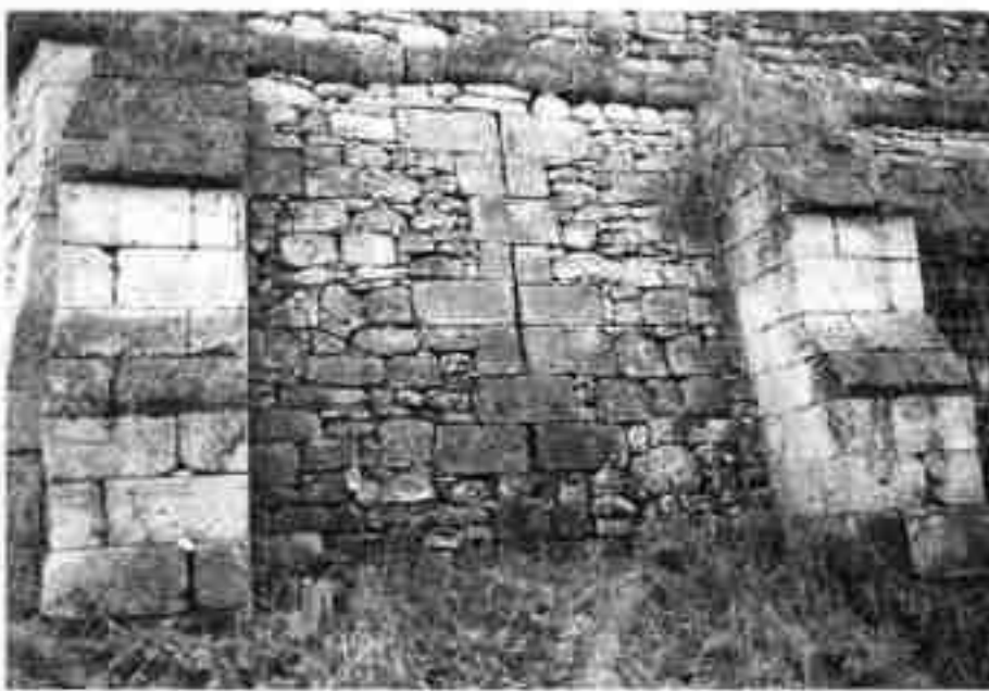
C - Ce mur armé de contreforts ne faisait que soutenir le jardin du presbytère de Soucy ▶
