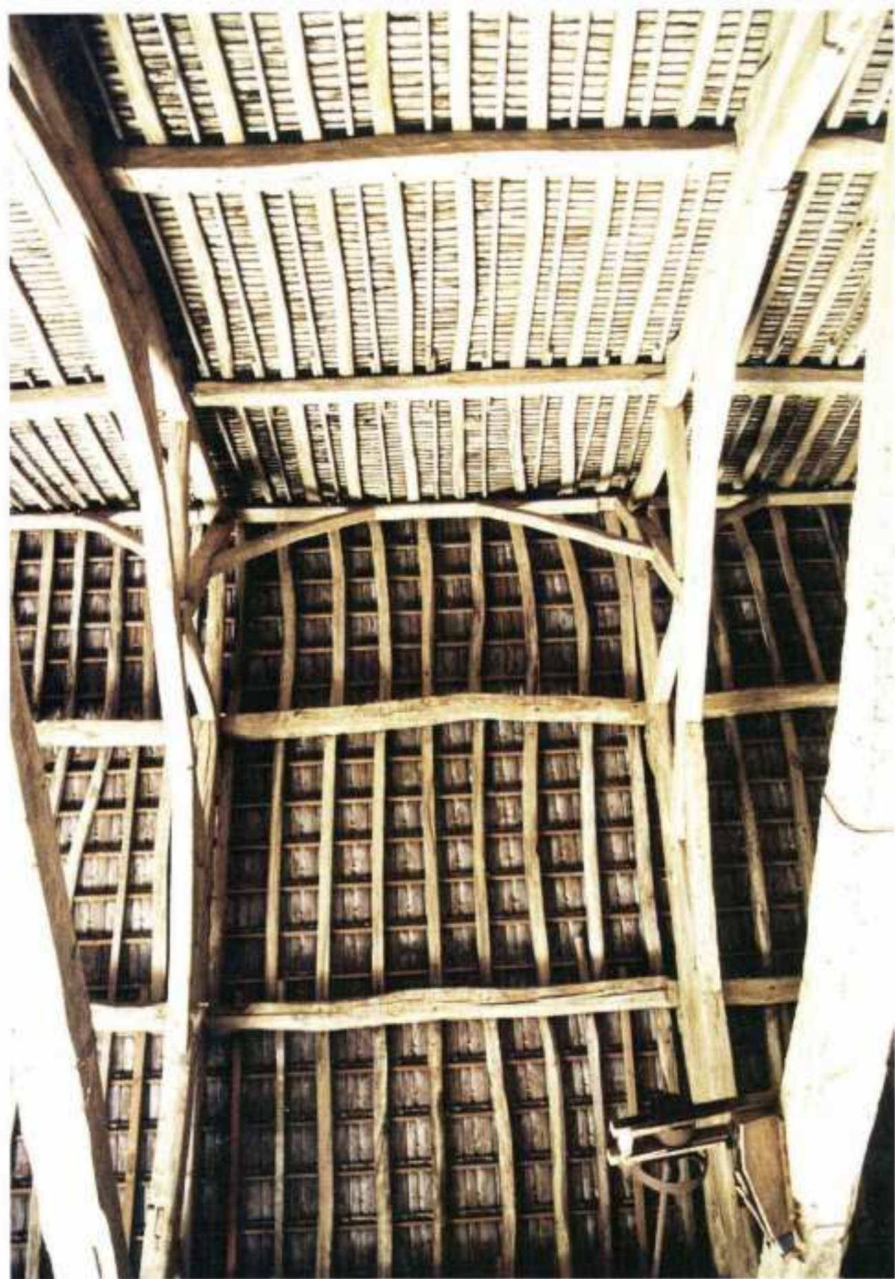
I-2 - Vue par dessous de la charpente d'une des granges de la ferme de Baisemont à Oigny-en-Valois. L'utilisation de pièces de bois tordues n'était pas un inconvénient pour les charpentiers. Sur l'un des versants (en haut) lorsque la couverture a été refaite, les liteaux trop fins, ont été soulagés par chevrons intermédiaires.
