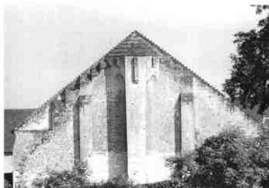
D - Soucy (abbaye de Saint-Médard). La reprise de maçonnerie, faite au XIX e siècle, destinée à réduire la pente du pignon est visible surtout à gauche. Au sommet la base de l'échauguette qui servait de ◀ poste de guet.
