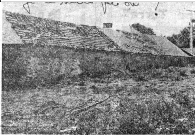
Le vent n'a pas épargné une tuile sur cette partie de la toiture.
